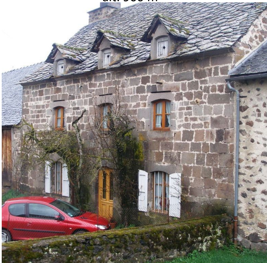
Poiriers de façade en très mauvais état, Bredon (Cantal) alt. 900 m
